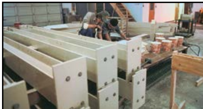
Columnas Dynaform construidas, listas para su envío.
