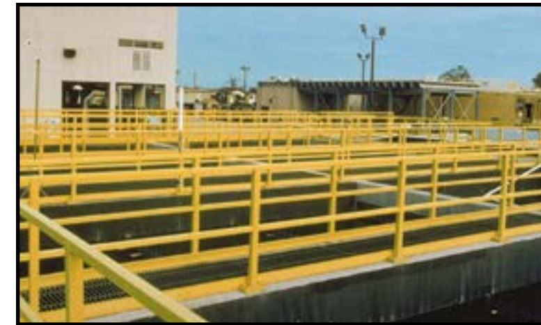
Los barandales de tubo cuadrado fabricados con componentes Dynaform ofrecen una larga vida útil en el entorno corrosivo de esta planta de tratamiento de aguas residuales.
